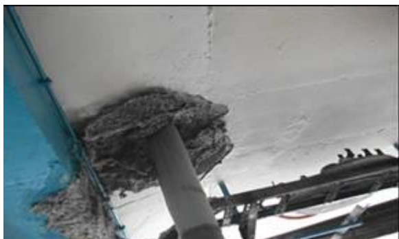
Figura 5. Korrozioni i betonit dhe armaturës
