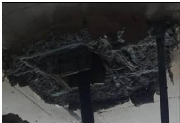
Figura 6. Korrozioni i betonarmesë
