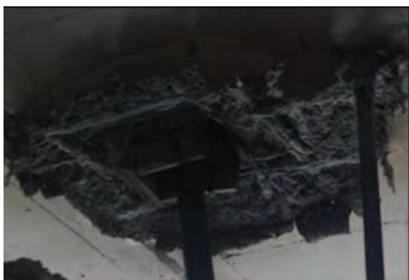
Figura 6. Korrozioni i betonarmesë
